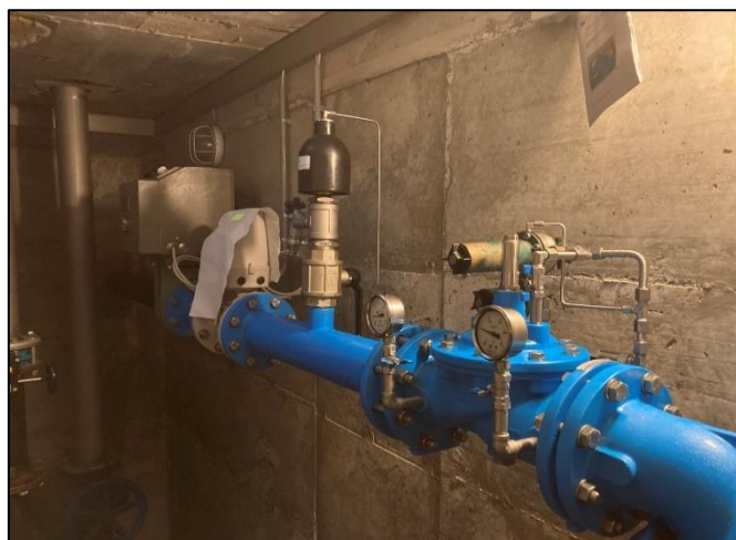
Foto 1: armature idrauliche da recuperare, linea di ingresso dalla distribuzione Falò
